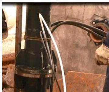
Ilustración 5.- Tubo neumático instalado en columna de impulsión
