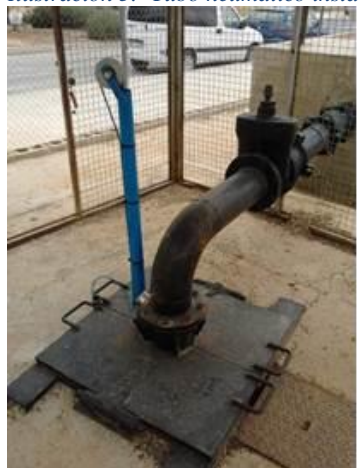
Ilustración 6.- Ejemplo e instalación sobre tubo porta-sondas
